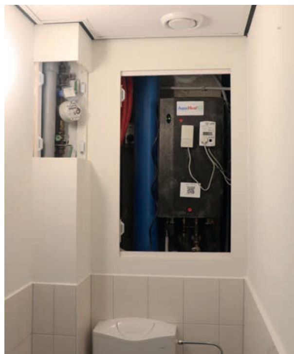
In de schacht achter het toilet is een nieuwe afleverset geplaatst voor verwarming en warm tapwater.
